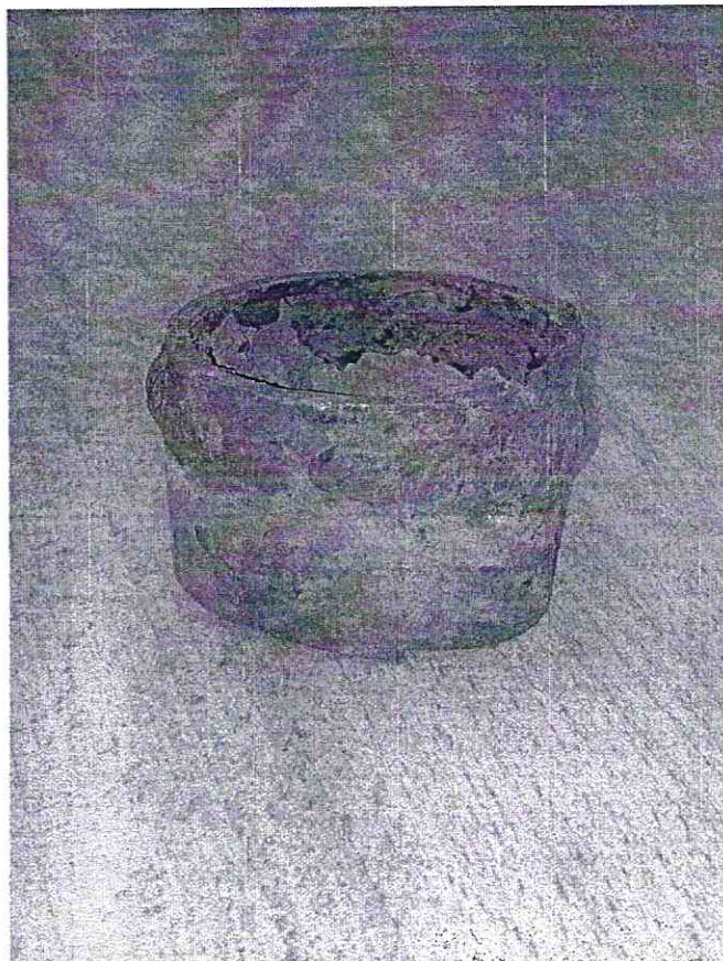
Фото №3. Внешний вид части трубы системы ГВС.
