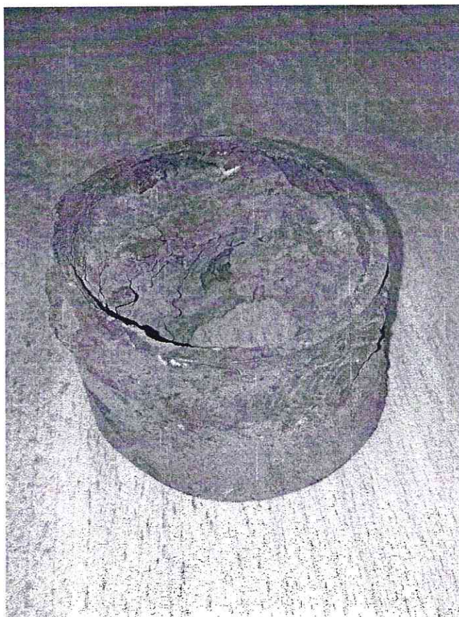
Фото №5. Внешний вид части трубы системы ГВС.
